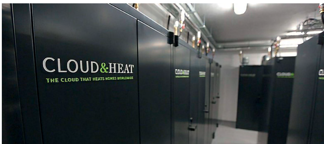
Ausgezeichnete Lösung von Cloud&Heat - Rechnen und Heizen für Nachhaltigkeit und Energieeffizienz in Rechenzentren Foto: Cloud&Heat Technologies GmbH
